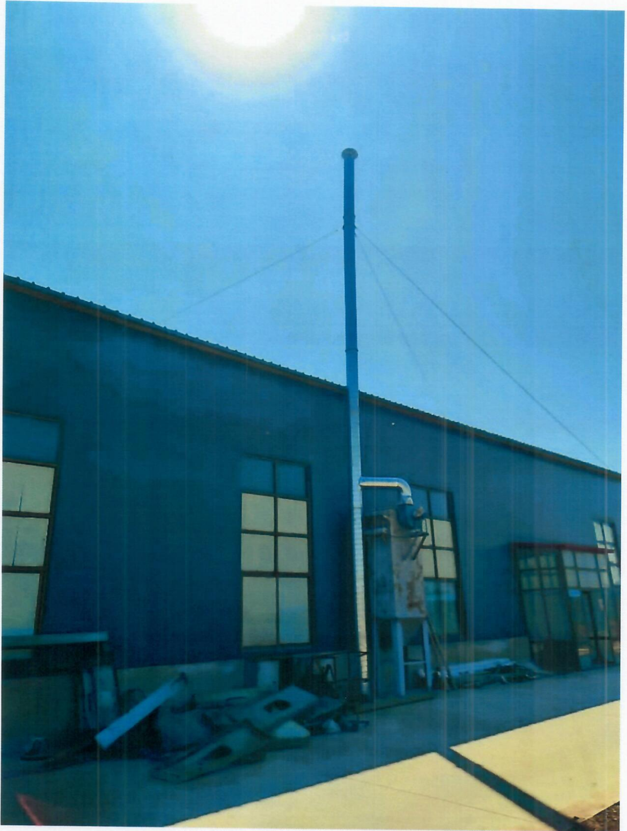
布袋除尘器+排气筒
